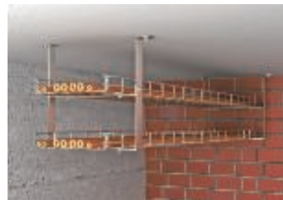
Таванен монтаж на две нива чрез скоба за окачване и междинна скоба
