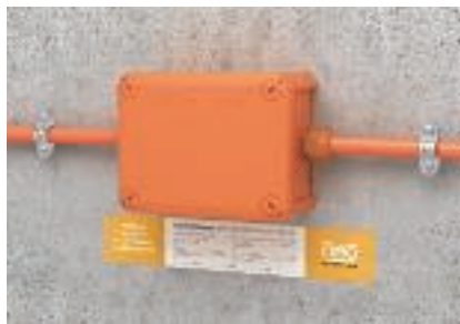
Готова монтирана кутия FireBox с обозначителна табелка
