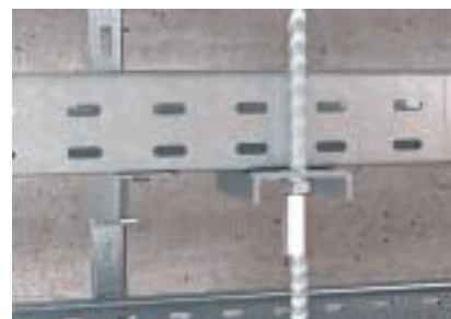
Закрепване на осигуряващи носещи шпилки към скарата при монтаж на няколко нива
