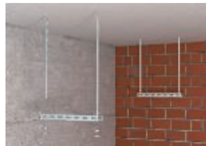
Монтаж на осигуряващи носещи шпилки с шестостенни гайки и широкополи подложни шайби
